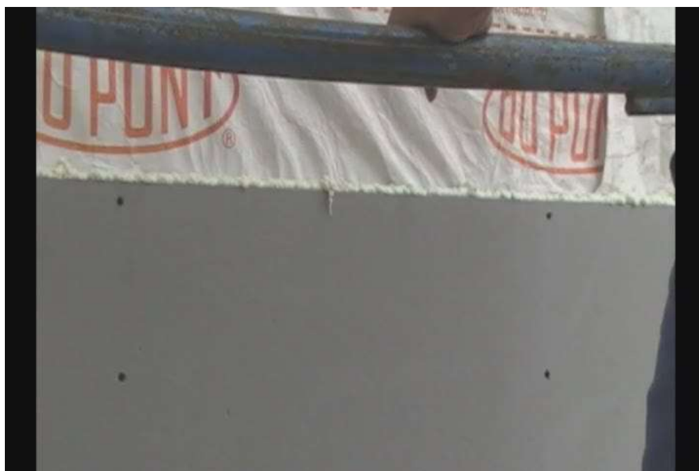
Рис.2.57 Закрепленная на каркасе здания плита низкой плотности с F-покрытием. На торец плиты нанесена монтажная пена.
