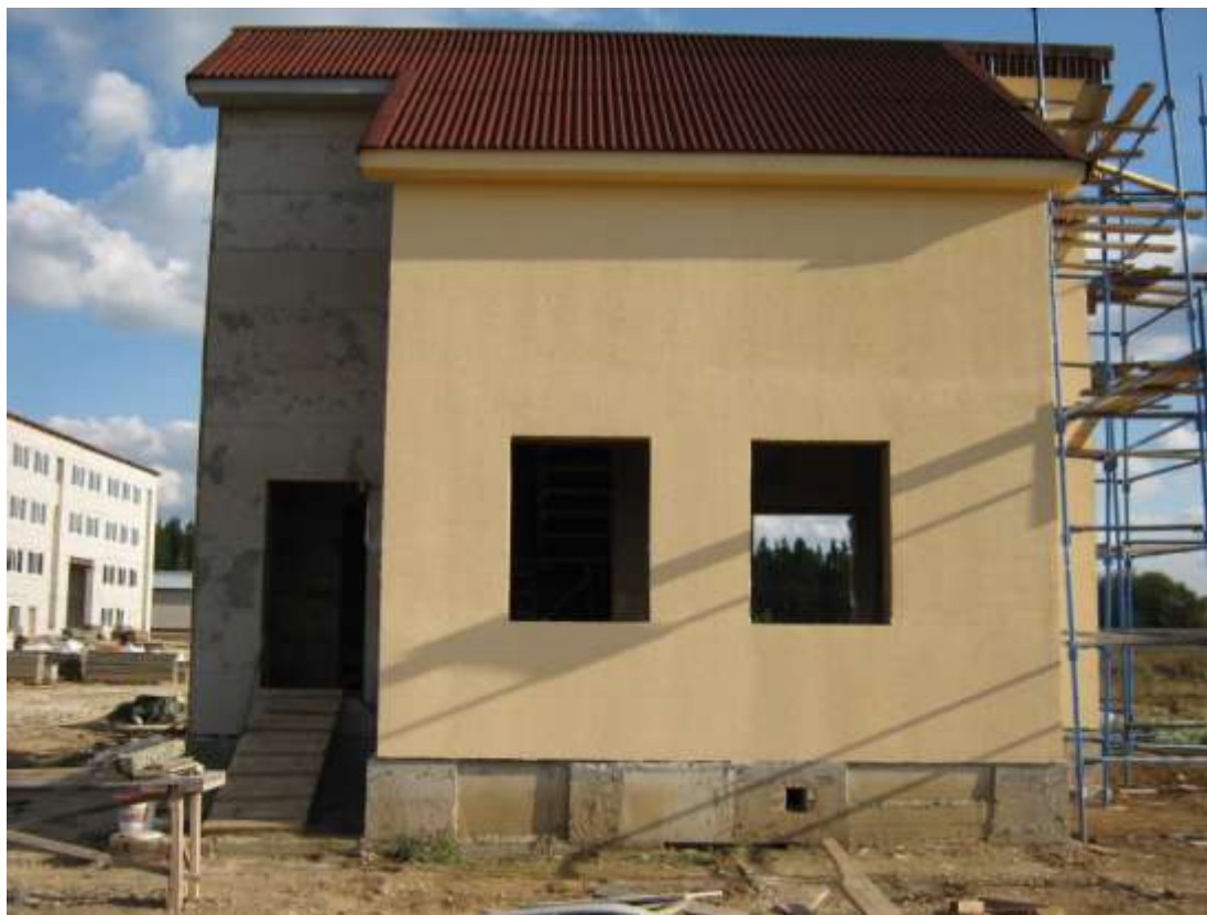
Рис.2.87 Стена, облицованная плитами GB-3F со швами с неровностями в местах соединения плит (в швах), покрытая эластичной штукатуркой
