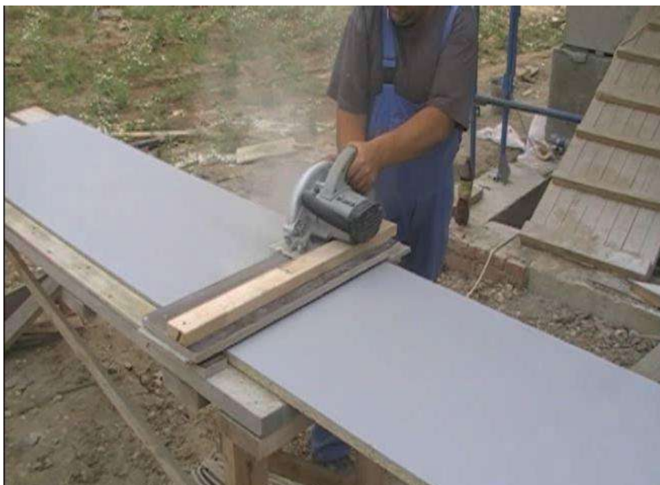
Рис.2.68 Резка плит GB-3F в размер на рабочем месте перед последующим монтажом на стену
