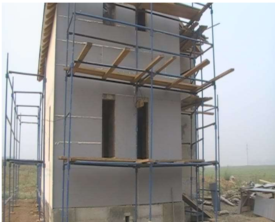
Рис.2.27 Стена дома со смонтированной плитой GB-600. С части швов пена ещё не удалена. Наличие выступающей из шва монтажной пены признак его полного заполнения.
