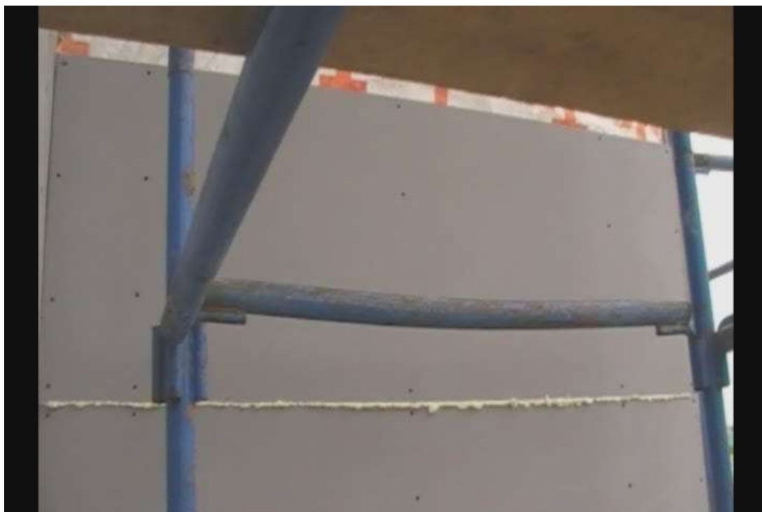
Рис. 2.58 Наличие выступающей из шва между плитами GB450 монтажной пены признак его полного заполнения
